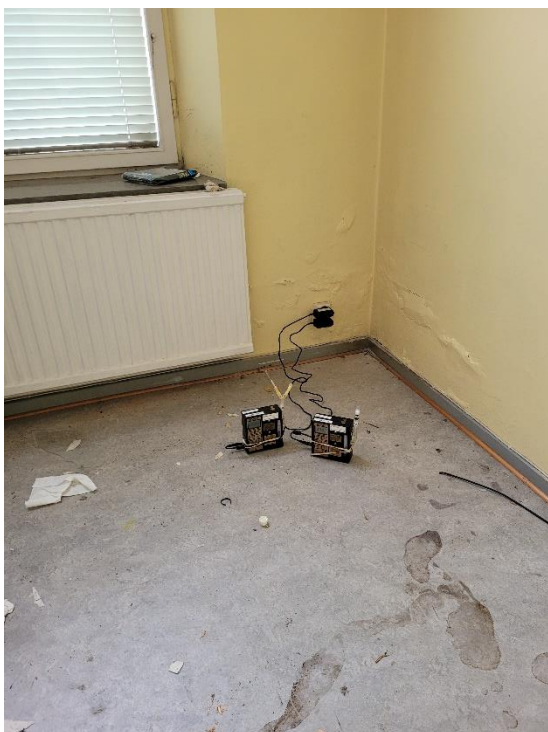
Figur 14. Närbild på provtagningsutrustningen vid provpunkt "Rum". Här kan man se en fuktskada på väggen.
