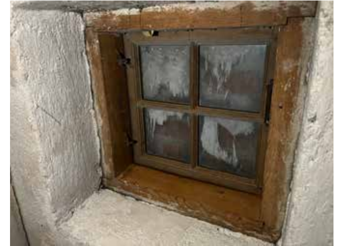
Utvändigt igenmurat vindsfönster.
